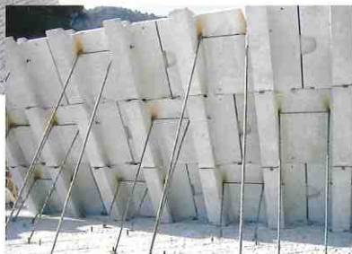
砂防堰堤サポート状況
